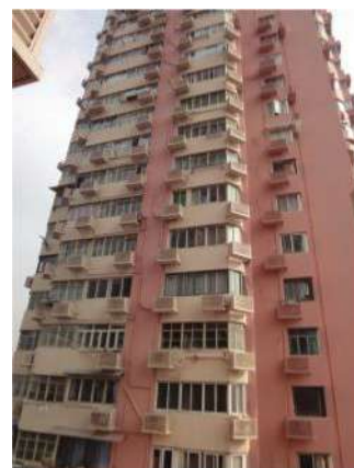
Appareils de climatisation type « split » sur la façade d'un bâtiment à Ouagadougou (Burkina Faso)
