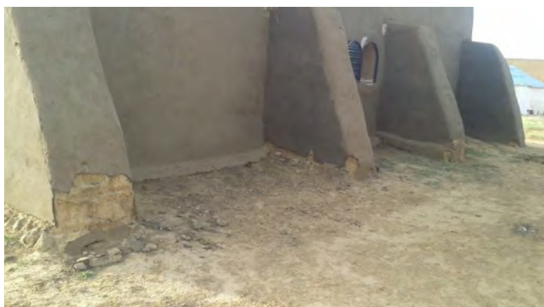
Photo15 : l'enduit en goudron qui s'est décollé suite aux pluies
