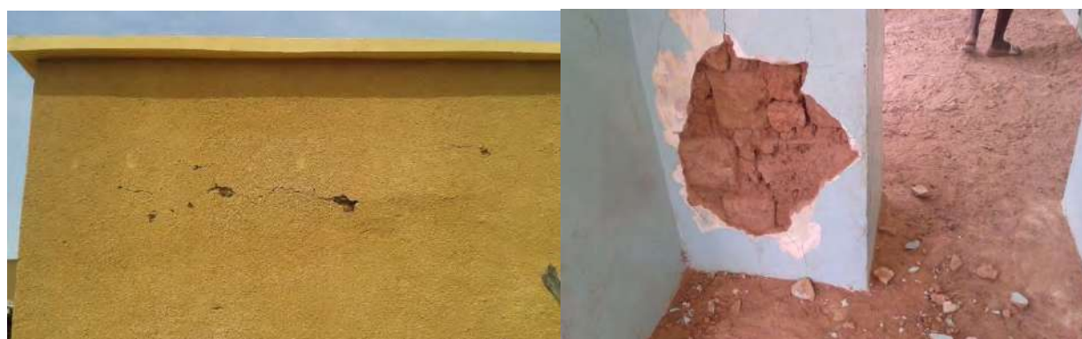
Photo17 : Des pathologies (fissures et décollements) observées
