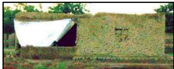
Figure 5 : Toiture en tôle défailante, Saaba ; Wyss 2005
